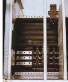
8E装置小室 8E device compartment
