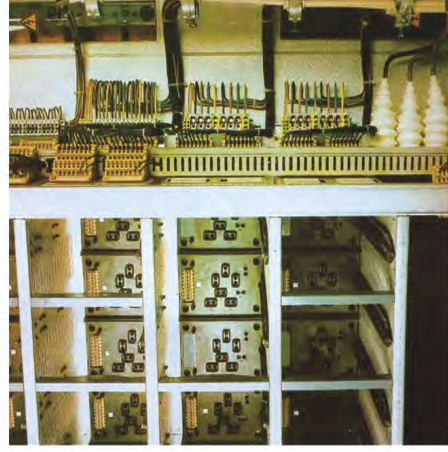
电缆和控制线在开关柜中的接线方式 Cable and control lines connection method in switchgear
